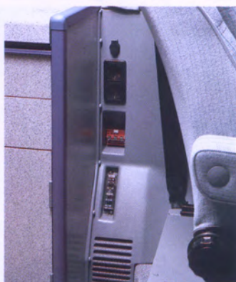
Elektrische Versorgung für den Wohnbereich
